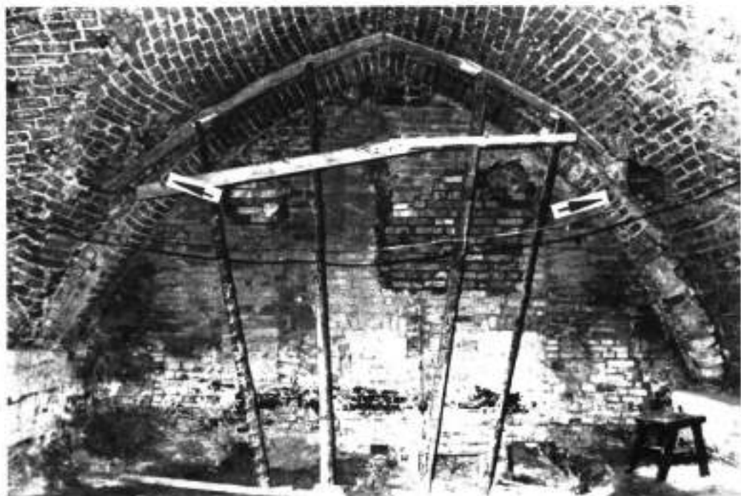
6. Piwnice. Ściana południowa sali głównej. W sklepieniu po obu stronach wloty przewodów wentylacyjnych
