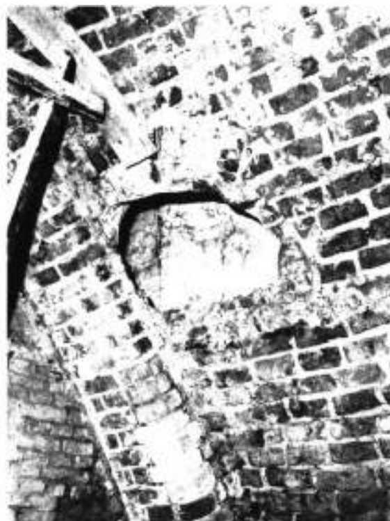
7. Piwnice. Wlot przewodu wentylacyjnego. We wnętrzu widoczny brak przewiązania między ścianą a murem podporowym sklepienia
