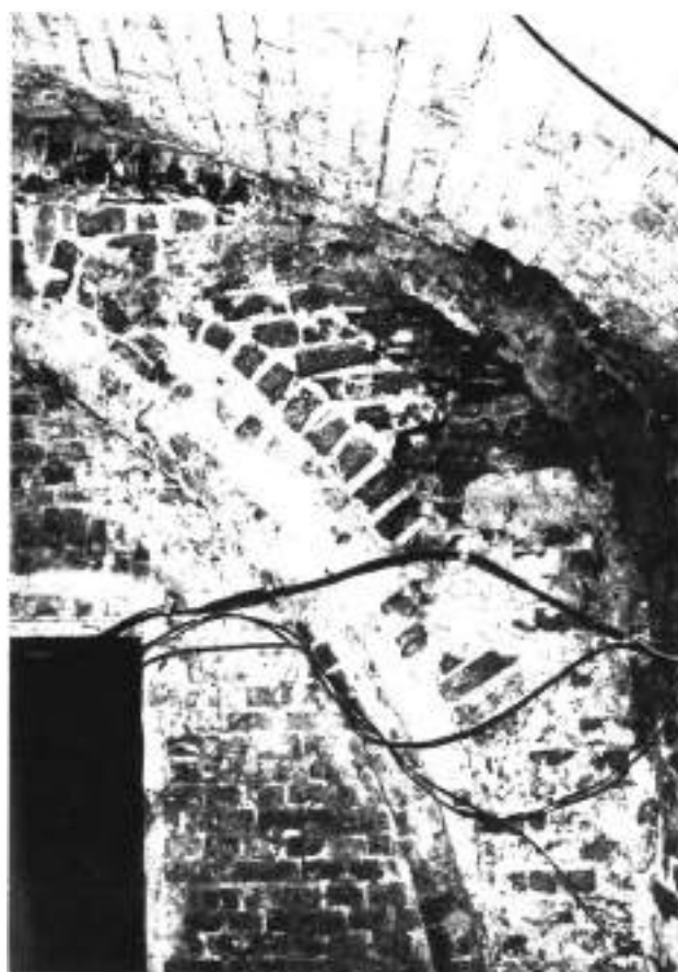
4. Piwnice. Pomieszczenie od strony ul. Chlebnińskiej na osi nawy zachodniej. Widok w kierunku sali głównej
